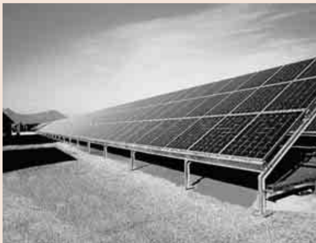
Instalaciones de energía solar de la empresa alicantina.
